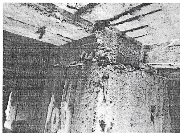
Осадочные деформации фундамента № 108 – отрыв.
